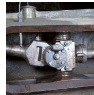
Salin de Griraud (04), usine de la société Solvay et Cie : détail d'un compresseur à vapeur
