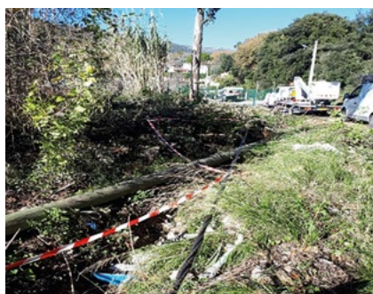
Photo 3 R – Poteau détruit – Route de la Baronne
